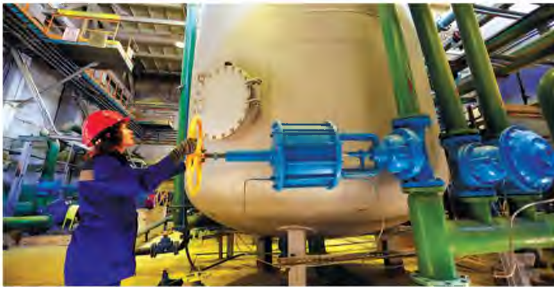
Ионообменные фильтры в корпусе №188 предназначены для первого этапа обессоливания воды
